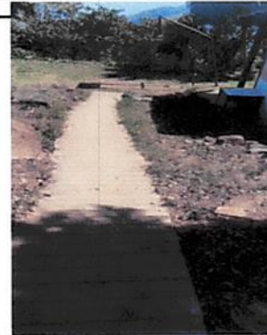
Foto 4: Raampa de acceso deteriorada.
