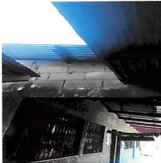
Foto 5: Grieta en la pared y falta de bajadas de agua
