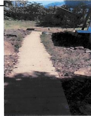
Foto 4: Raampa de acceso deteriorada.
