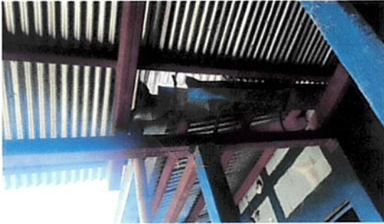
Foto 3: Canal y bajadas de agua deterioradas
